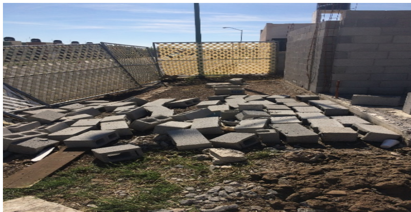
Figura 10. Muro caído (Fuente propia).
